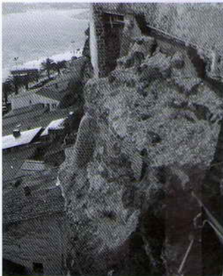
Vista de mampostería de irramiento de mampostería en el acantilado del Puerto de Mahón. A la derecha, vista del andamio en el andén de Poniente.
