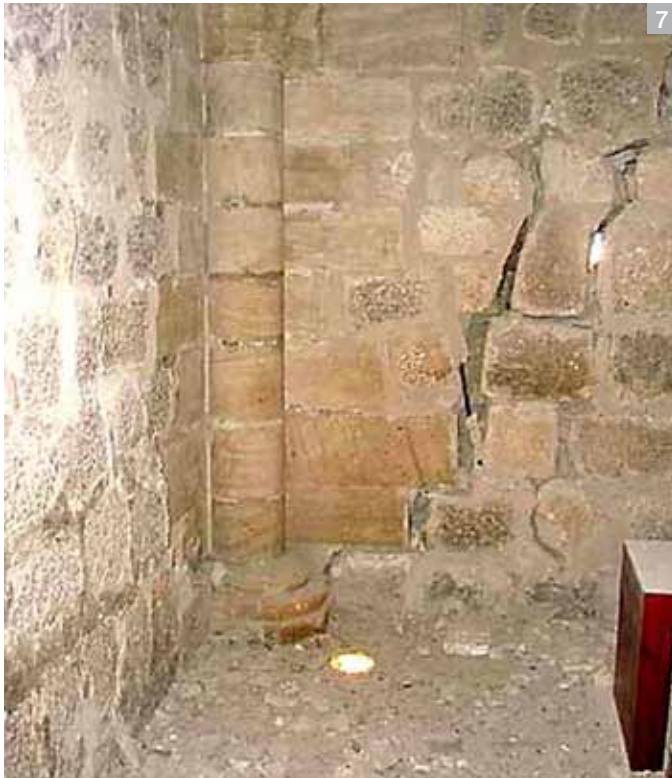
Lámina 7. Soporte del rincón noroeste de la bóveda superior con un desplazamiento de 15 centímetros que deja a la basa fuera del fuste.
